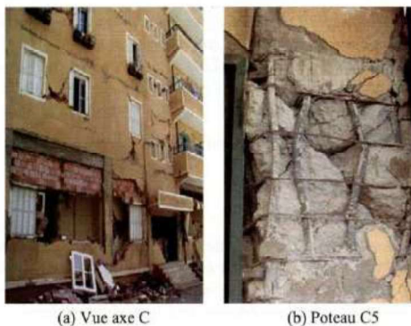
Figure 3 : Dommages subis par la structure
